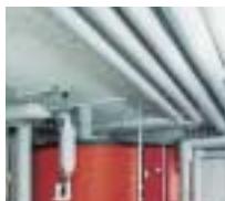
Le tubazioni isolate conservano del calore prezioso nel tubo.
