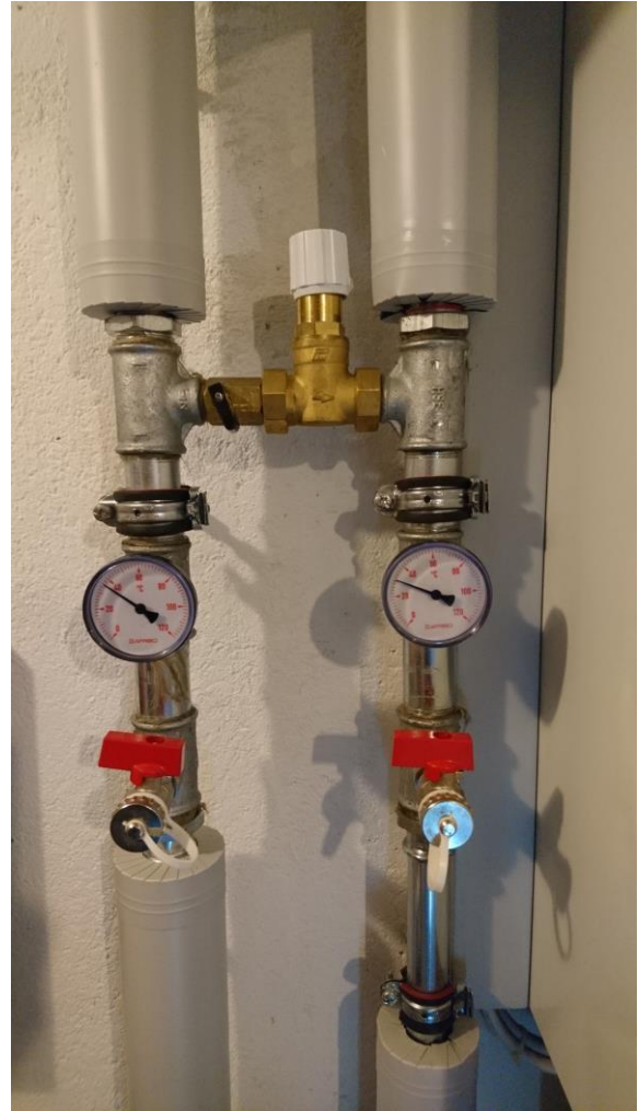
Abb. 2: Überströmventil nicht einreguliert
