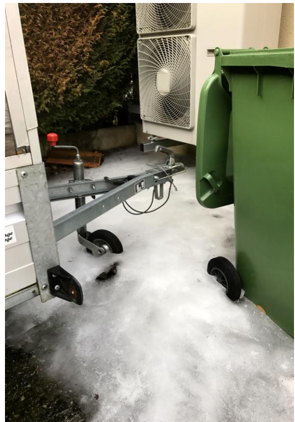
Abb. 6: Wenn der Kondenswasserablauf nicht funktioniert, beginnt der Eisaufbau am Boden unter der Wärmepumpe
