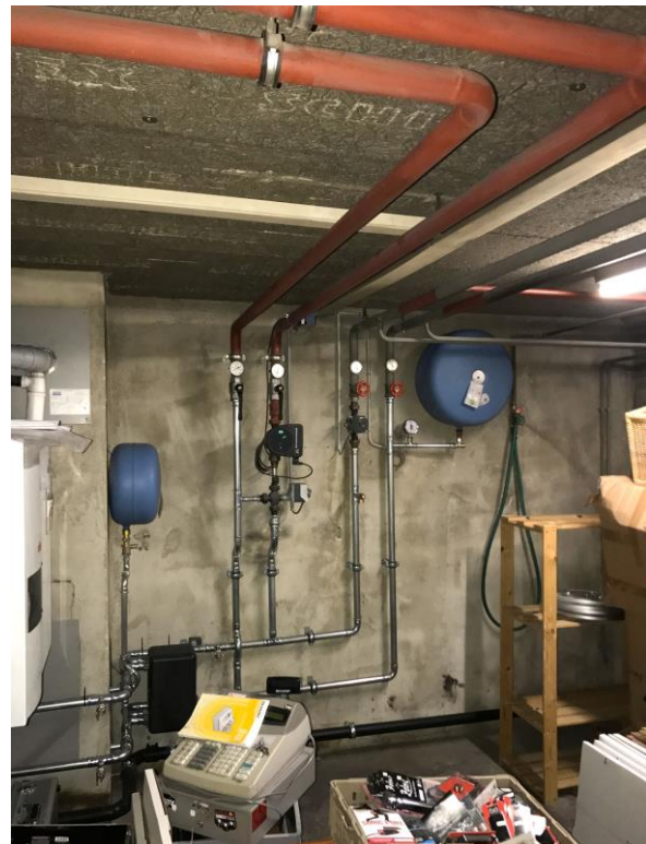
Abb. 8: Auch bestehende Heizleitungen sind kein Thema bezüglich Isolation
