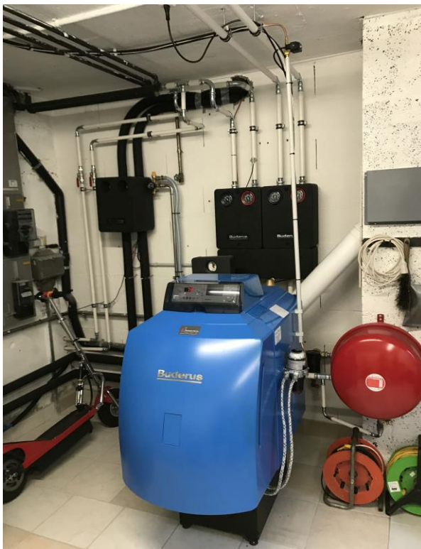
Abb. 7: Bei Gasheizungen ist die Situation analog, die Leitungen sind oft nicht isoliert
