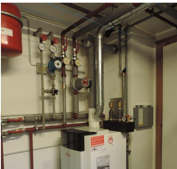
Abb. 3: Bestehende alte Umwälzpumpen nicht ersetzt
