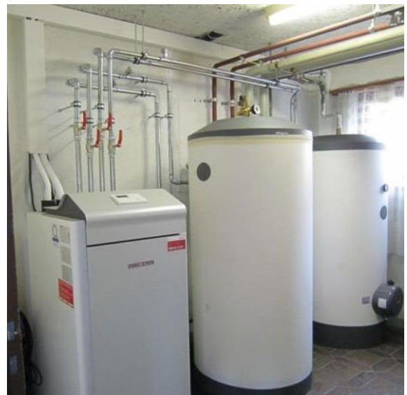
Abb. 4: Leitungen nicht isoliert und kein Thermosiphon in Warmwasserleitung
