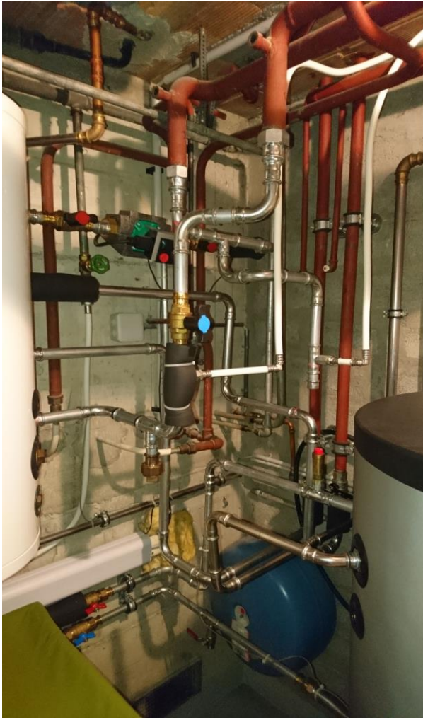
Abb. 1: Alle Leitungen unisoliert
